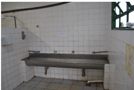
Fotografia 3 – Lavatório calha. Não havia sabão, álcool em gel ou papel toalha disponível no local aos acolhidos.
