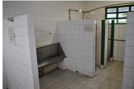
Fotografia 4 – Mictório calha e chuveiros com aquecimento elétrico em banheiro destinado a acolhidos.
