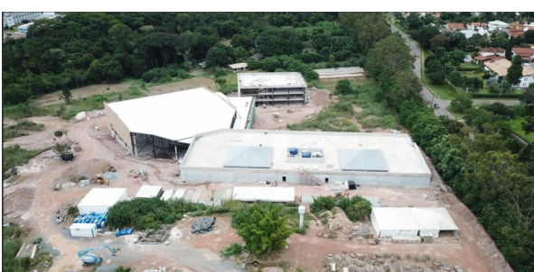
Figura 4: Mostra a obra em avançado estágio, mesmo sem alvará de construção. Imagens de março de 2021. Fonte: Requerimento protocolado na ouvidoria do MPDFT sob o número 139336.
