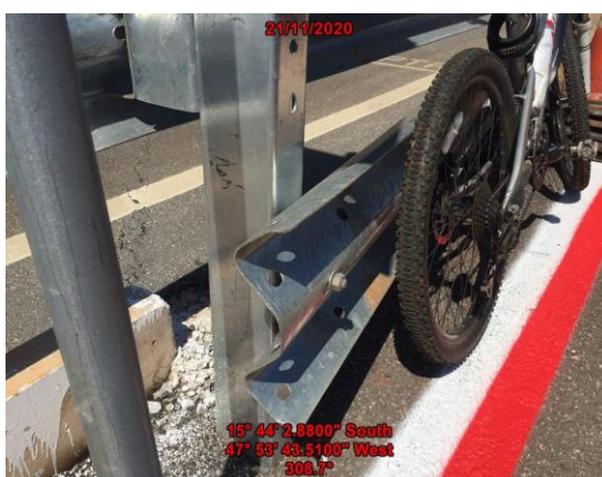
Estrutura pontiaguda e cortante voltada para a ciclovia
